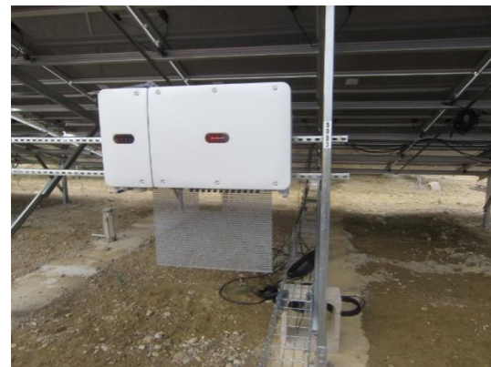
Figure 11 : Exemple d'onduleur décentralisé – Source : NEOEN
